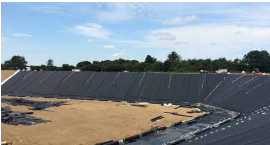
Figur 3. I den danska staden Vojens har man byggt ett groplager för vatten värmt av 70 000 kvadratmeter solfångare. När det är fyllt med 203 000 kubikmeter vatten är det täckt med flytande isolering. Mer än 50 procent av stadens värmebehov klaras med solvärme.
